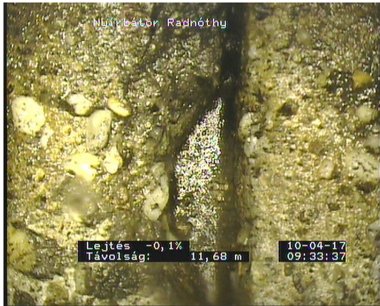
Csatlakozásnál mentén csőperem törés, hiány.
