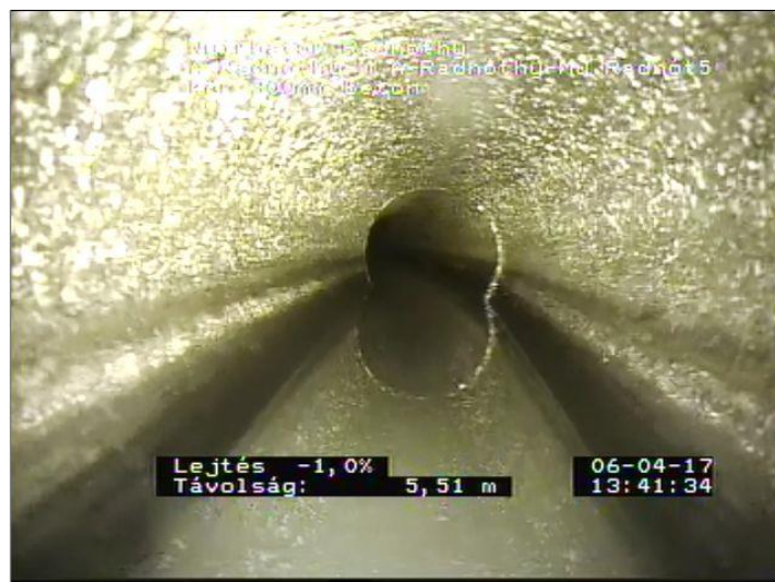
A vezetékszakaszk kikavicsosodása.
