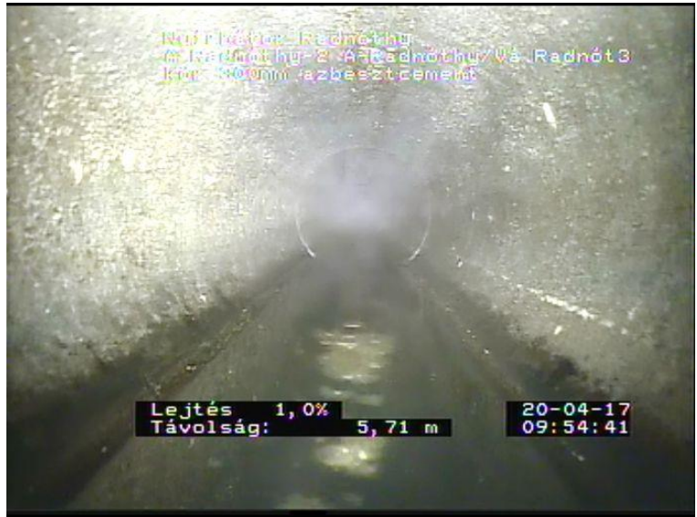
Az azbesztcement csövön kismértékű vékonyodás tapasztalható.
