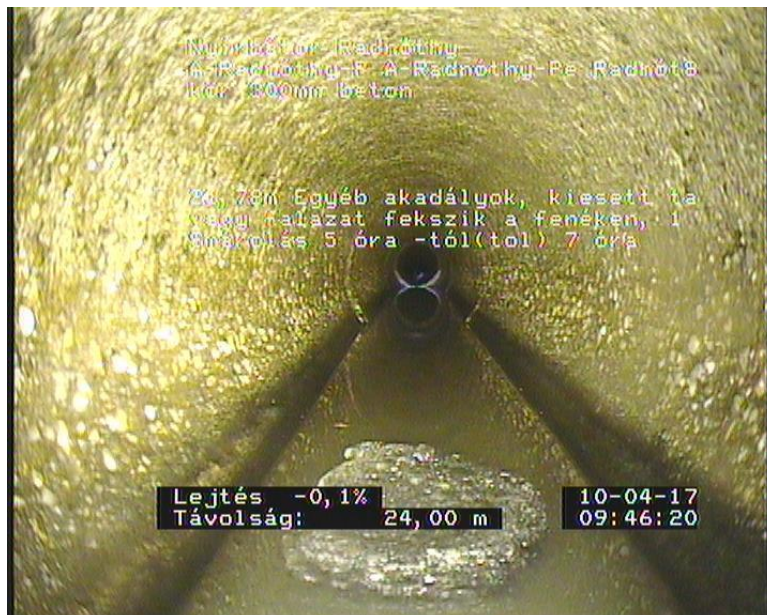
Folyásfenéken betonbefolyás. Erős kikavicsosodás.
