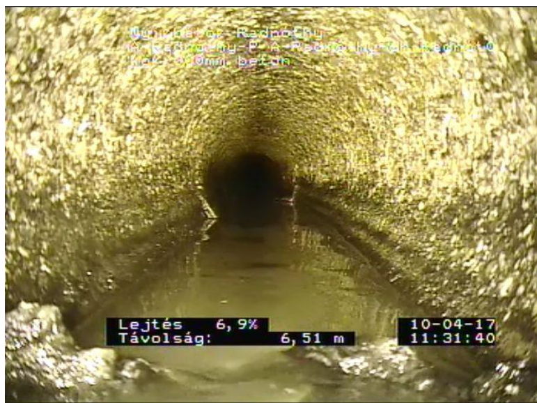
6,51 m-nél folyásfenékben betonbefolyás. Erős korrózió kikavicsosodás.
