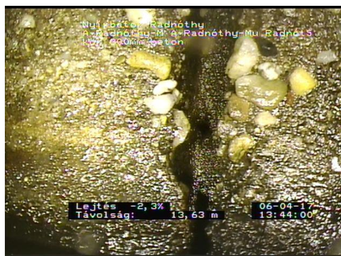
Csatlakozásnál csőperem törés.
