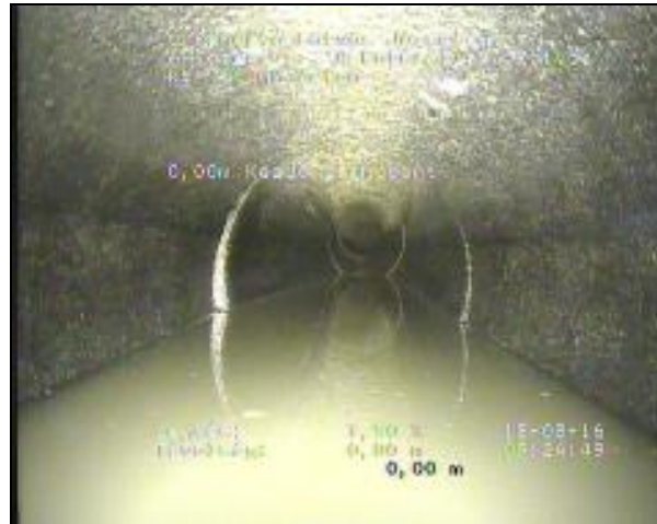
Toldásoknál vezeték elcsúszás
