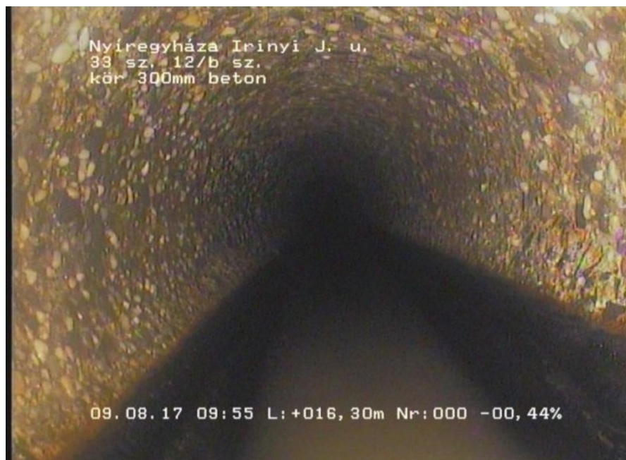
Irinyi6_faf783e2-63ce-471c-8ab0-0029aa13d2d8_20170809_095557_265.jpg, 00:02:59, 16.30 Felszíni károk, hiányzó adalékanyagok, vegyi korrózió - korrózió a szennyvíz miatt - károsodás a vízszint alatt..
