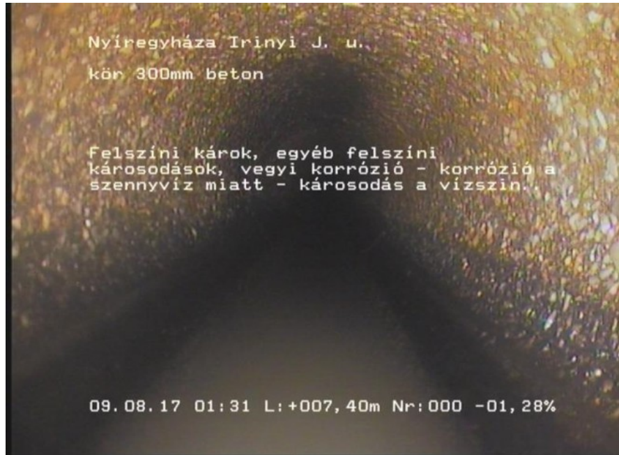
Irinyi 11_79afe06c-c489-4080-9cca-e8219f656a04_20170809_133103_911.jpg, 00:02:13, 7.40 Felszíni károk, egyéb felszíni károsodások, vegyi korrózió - korrózió a szennyvíz miatt - károsodás a vízszin..
