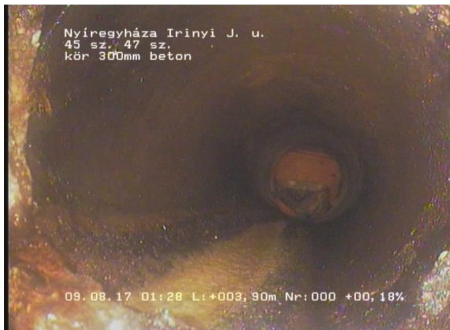
Irinyi 11_a3c7b41e-14d4-4be9-a32a-1d4068499d3a_20170809_132841_730.jpg, 00:00:39, 3.60 Csatlakozás, ismeretlen csatlakozás, csatlakozás nyitva, 300mm 12 óra
