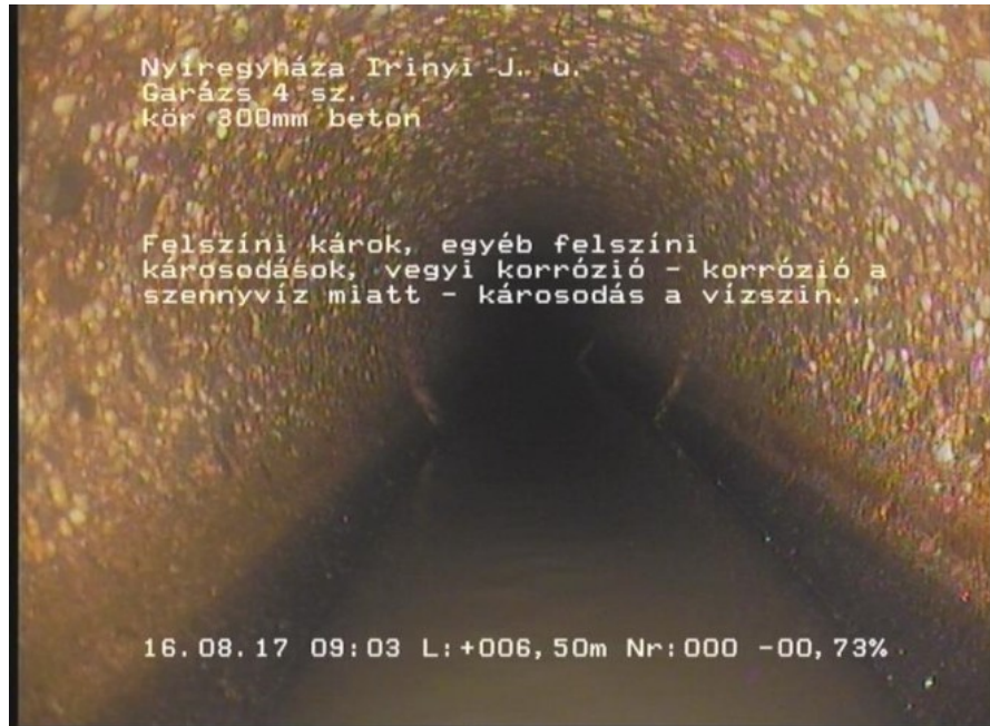
Irinyi 13_01f3b27e-0506-45fa-9a6c-0f362e60c101_20170816_090415_548.jpg,00:01:01,6.50 Felszíni károk, egyéb felszíni károsodások, vegyi korrózió - korrózió a szennyvíz miatt - károsodás a vízszin..
