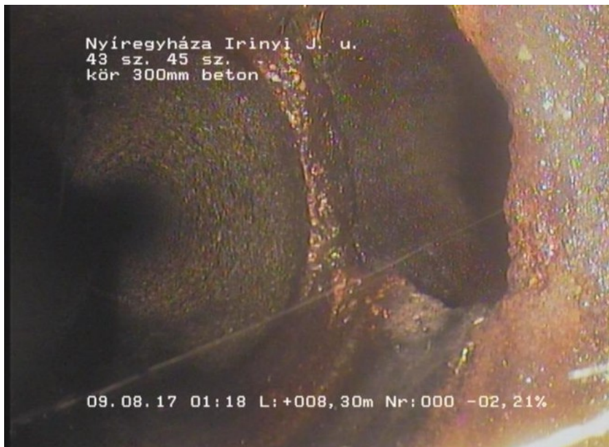
Irinyi 10_439a2b90-6e2f-48d8-8d11-781c2a72c98e_20170809_131923_277.jpg, 00:01:29, 8.30 Csatlakozás, ismeretlen csatlakozás, csatlakozás nyitva, 300mm 12 óra
