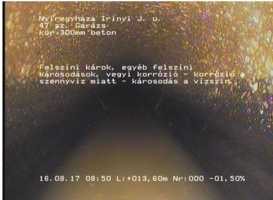
Irinyi 12_02a9954d-af87-48e1-9a2f-df3b5090a1cb_20170816_085058_612.jpg,00:01:01,13.60 Felszíni károk, egyéb felszíni károsodások, vegyi korrózió - korrózió a szennyvíz miatt - károsodás a vízszin..
